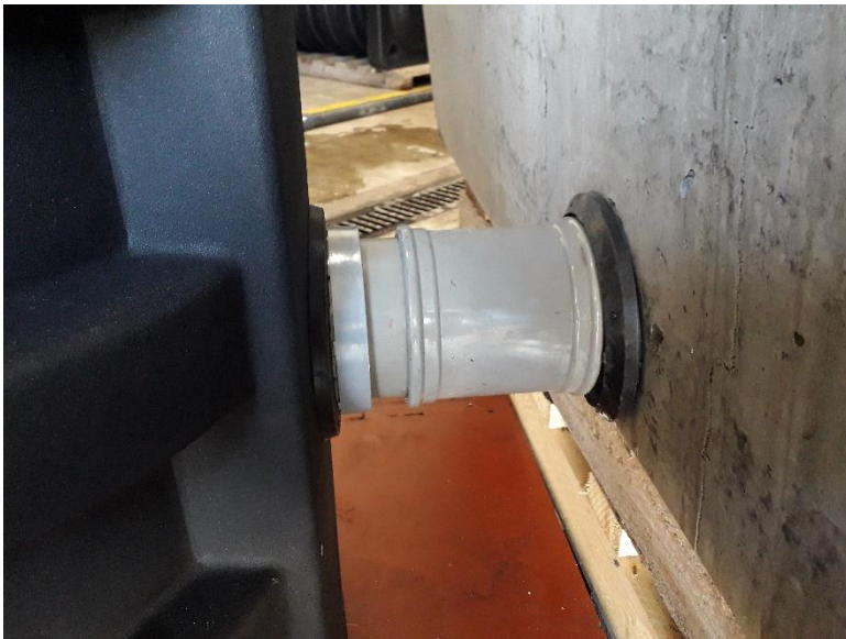
Fig. 5 – raccordement de la chambre d'échantillonnage au filtre compact x-perco® C-90 5 EH
